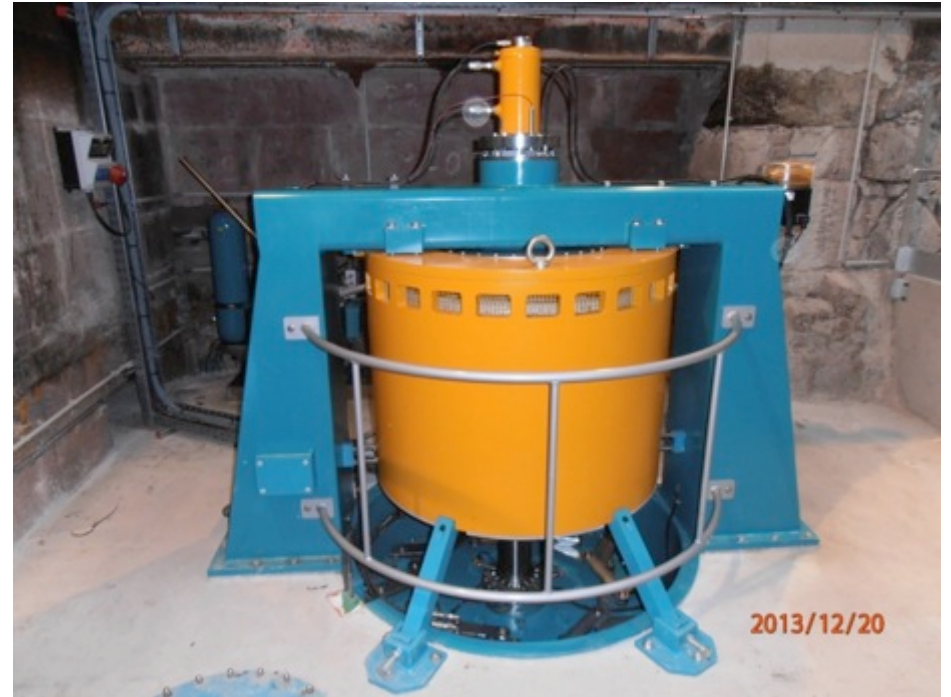
Centrale du Couvent à 68140 Munster
